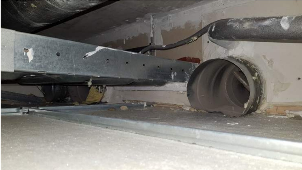
Figuur 6: Verse lucht voor de lokalen werd via oude afzuigkanalen ingeblazen boven het verlaagde plafond. Omdat dit ongunstig was voor de luchtkwaliteit, is de situatie aangepast.
